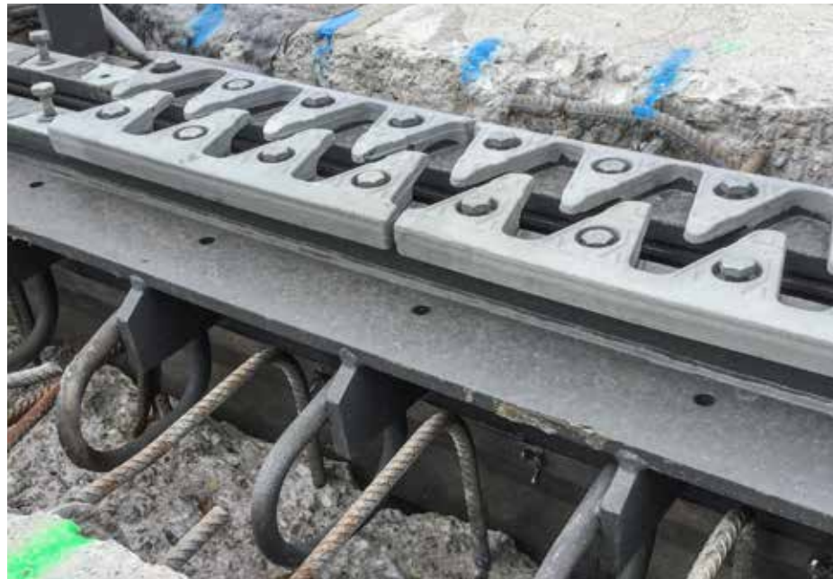
Der Fahrbahnübergang gewährleistet, dass der Übergang zwischen Brückenelementen sicher überfahren werden kann.
