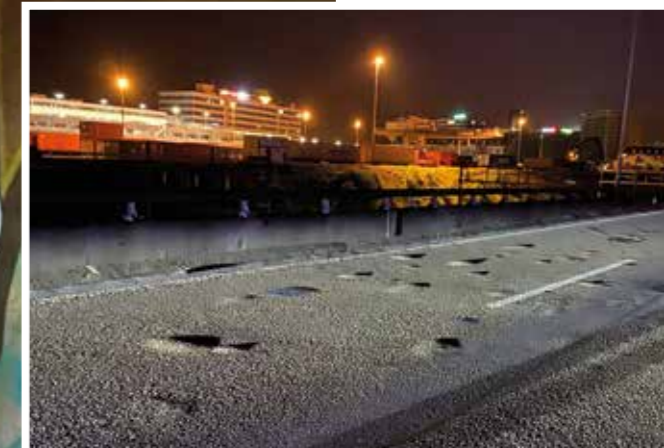
Nachts sind die Unebenheiten im Fahrbahnbelag deutlich zu sehen.
