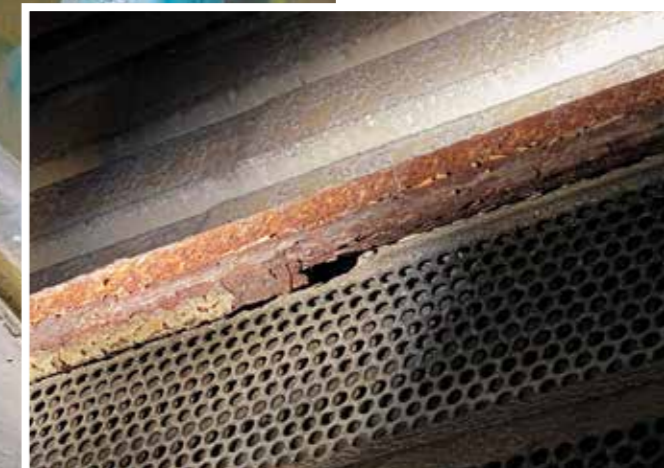
Korrosionsschaden am Profil einer Schallschutzwand.
