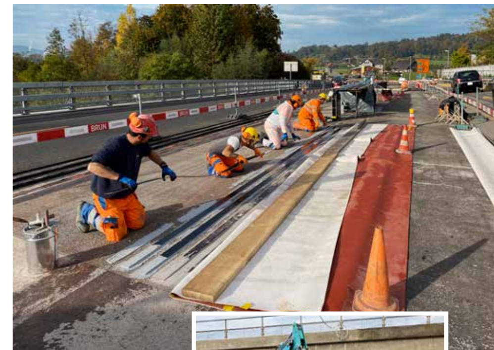
Teamgeist und genaues Arbeiten sind gefragt beim Verlegen der Lamellen aus kohlenstofffaserverstärktem Kunststoff (CFK), welche die Brücke verstärken.
