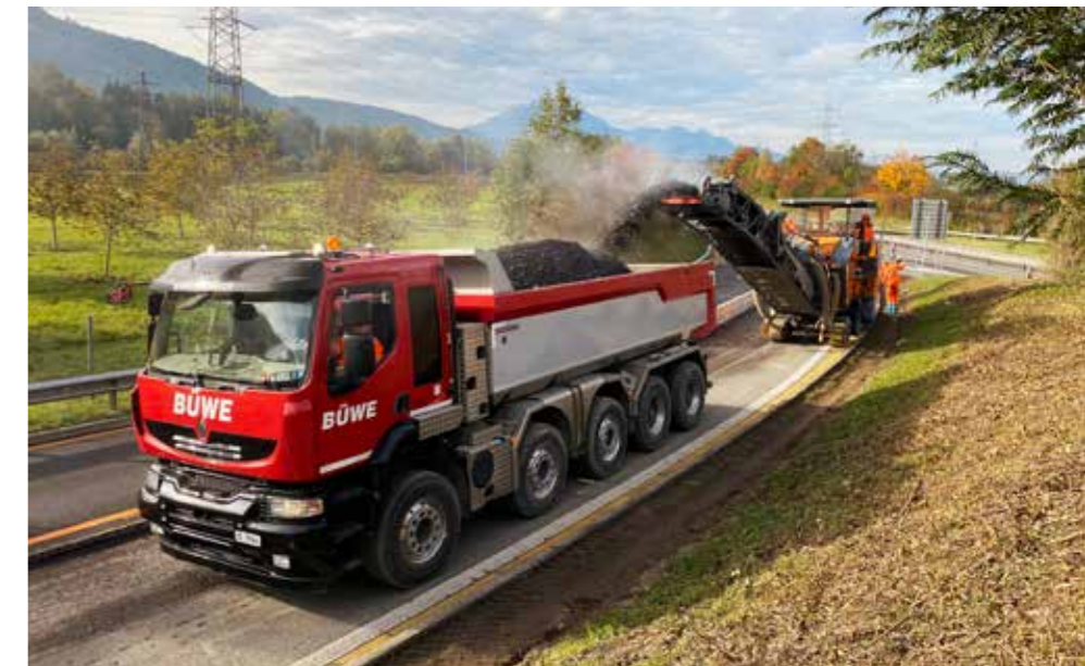
Die oberste Schicht des Asphalts wird abgefräst, bevor der neue Deckbelag eingebaut wird.
